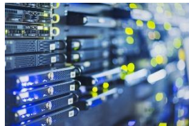
データセンター
